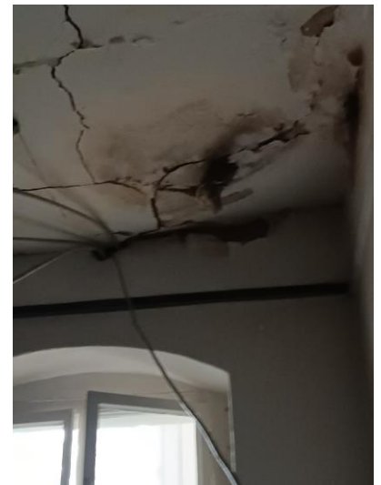
Bild: Deckenschaden (Quelle: Steinhausen)
